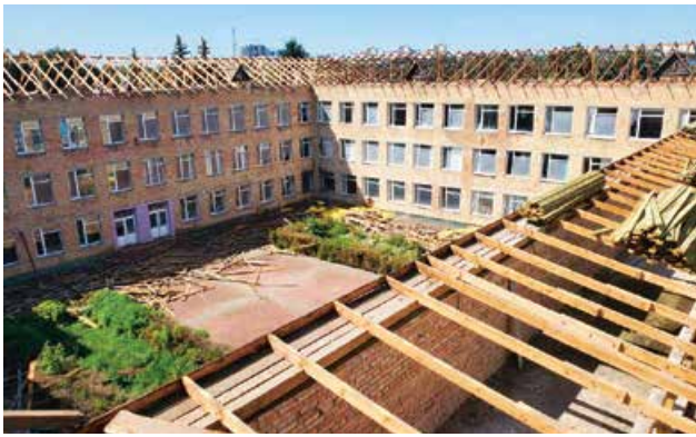
An der Schule in Butscha wurde das während der Kämpfe stark beschädigte Dach mit Projektmitteln von ca. 90.000 € komplett erneuert
