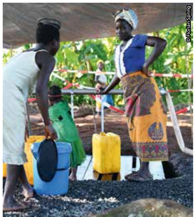
Sauberes Wasser fließt aus dem Hahn eines Wasserverteilungssystems im Bezirk Dombe in Mosambik.
